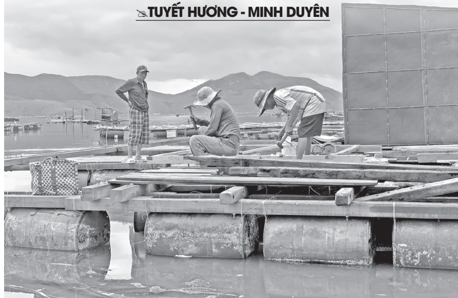
Các bè nuôi bị hư hỏng ít, bà con sửa chữa ngay trên mặt đầm. Ảnh: T. Hương
